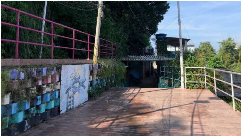
Figura 3. Atual estado de um dos decks/mirantes construídos no morro da Babilônia durante o Programa Morar Carioca. Fonte: Thaisa Comelli, 2019.
