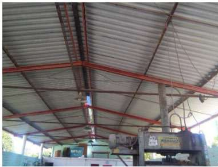
Figura 05: Falta de telhas no galpão da cooperativa. Fonte: Autor (2017).
