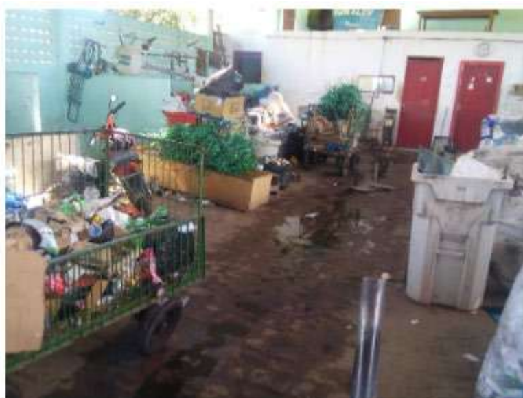
Figura06: Água em uma fração do galpão devido a problemas no telhado Fonte: Autor (2017).
